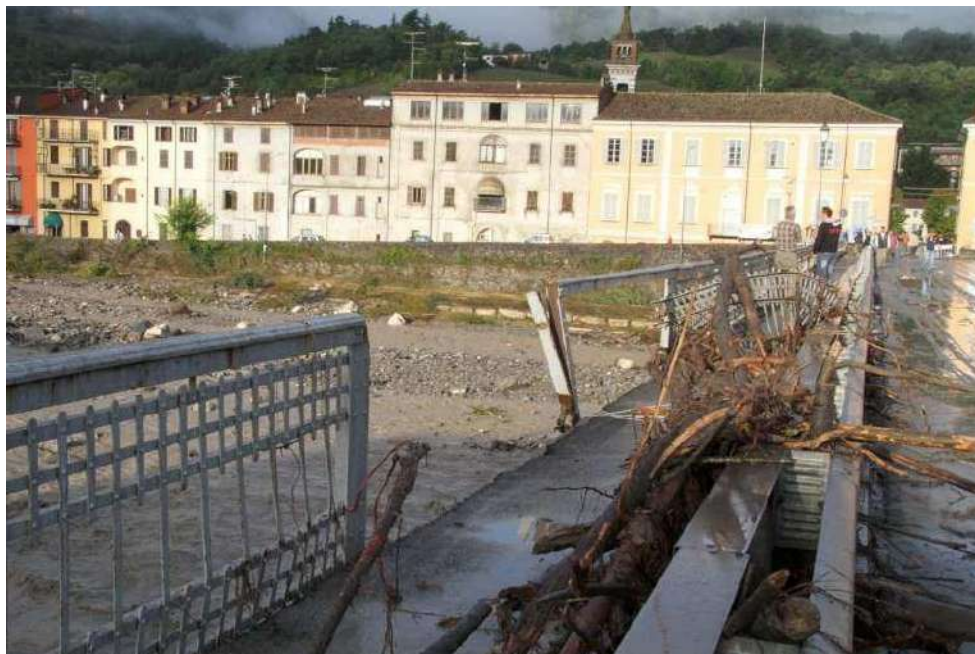
Figura 13: Il ponte sul Nure a Bettola, danneggiato dalla piena ( www.liberta.it ).
